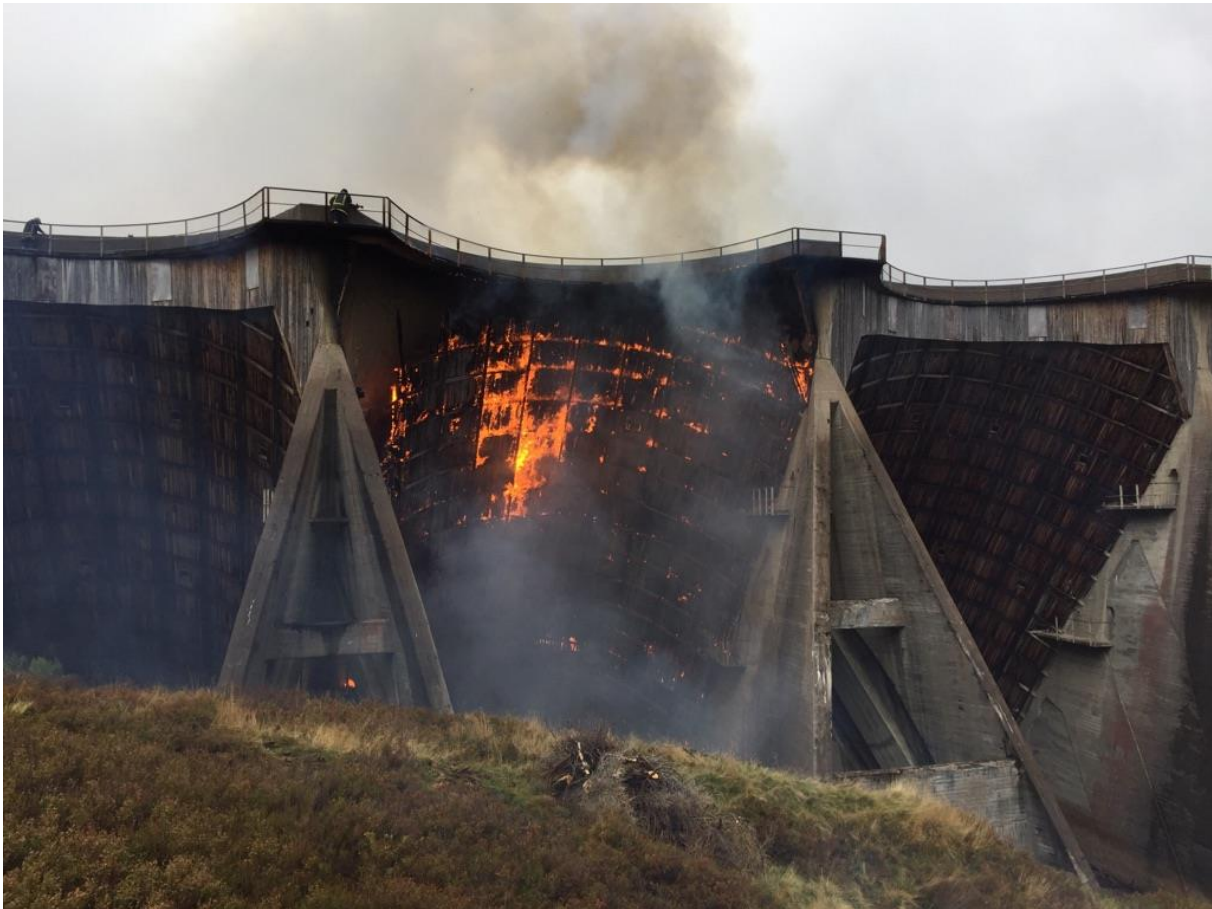
Figur 1 Ulykke – brann i frostvegg på flerbuedam (foto: Agder Energi AS)
