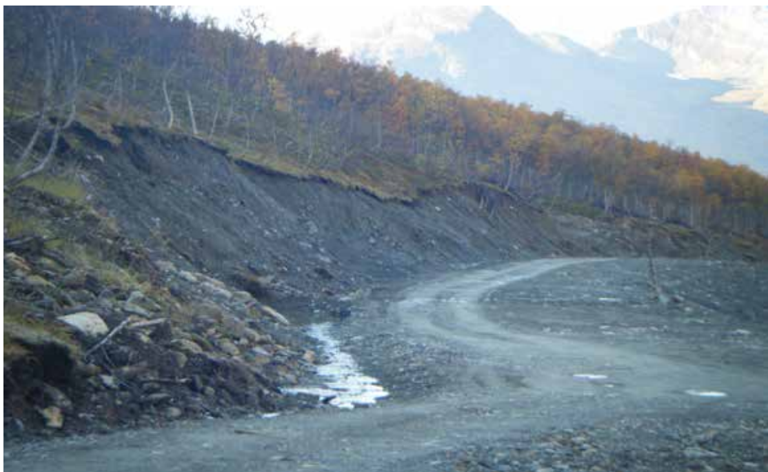
Figur 1: Midlertidige veier må utformes slik at det er mulig å legge dem igjen. Veibredden og veitraséen bør legges slik at man unngår å få store og ustabile skjæringer.
