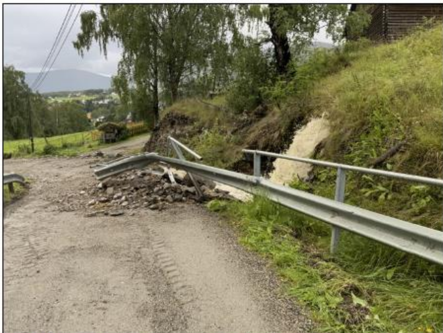
Figur 5-19: Eksempel på skade av vegggrøft/ veg på grunn av høy vannføring i Bjørgebekken etter «Hans».
