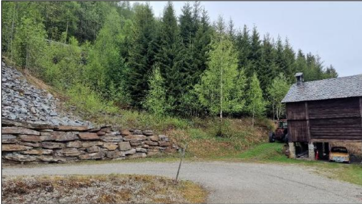
Figur 10-28: Oppbygning av støttemur og drenerende masser er lagt ovenfor i sideskråningen som tidligere har blitt utsatt for kraftig erosjon og mye vannføring. Til høyre i bildet har det kommet flere flomskredhendelser ned forbi stabburet og gått ned til toglinja. Både i 2010 og 2013 ifølge beboere.
