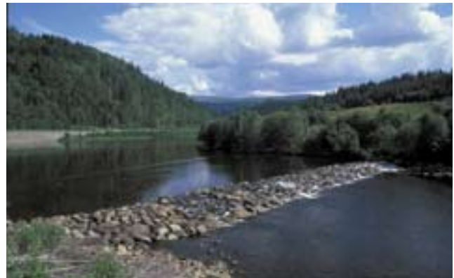
Bassengterskel med rett terskelkrona. Denne utformingen er den enkleste å bygge, men gir et lite naturlig inntrykk. Neavassdraget
