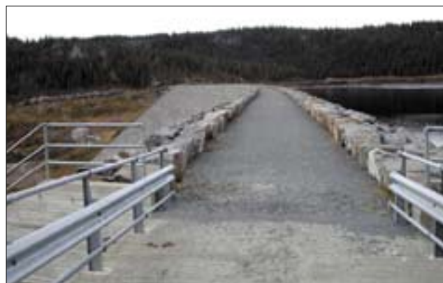
Det er viktig at dammens linjer er presise og at overganger og avslutninger er tydelige. Her er steinplastringen trekt opp slik at veibanen blir en forsenket del av damkronen. Denne løsningen kan i mange tilfelle være enkel, effektiv og elegant. Dokkfløydammen.
