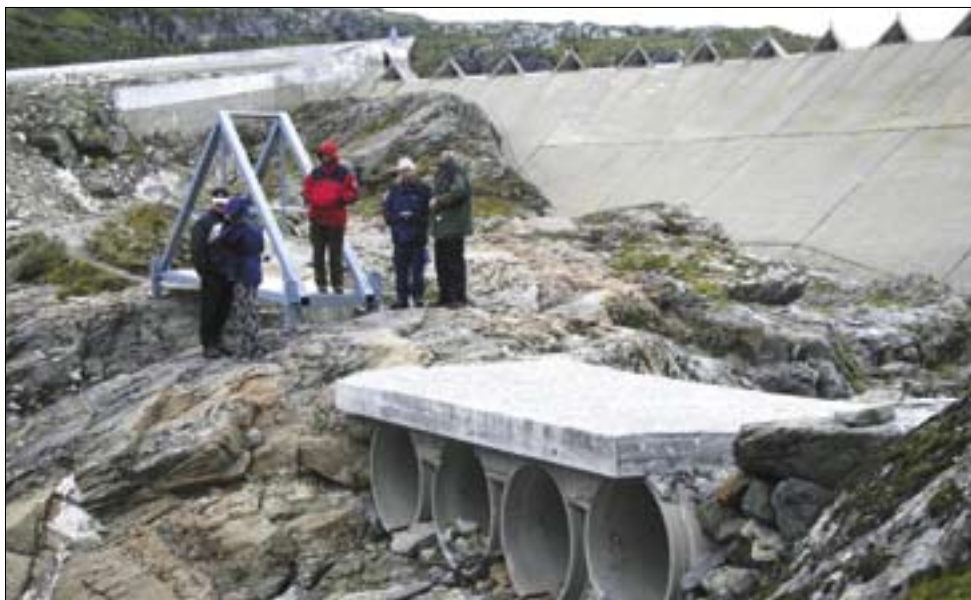
En systemrevisjon kombineres ofte med en anleggsinspeksjon for å se på sammenhengen mellom internkontrollsystemet og de faktiske forhold på anlegget. Dam Volavatn.
