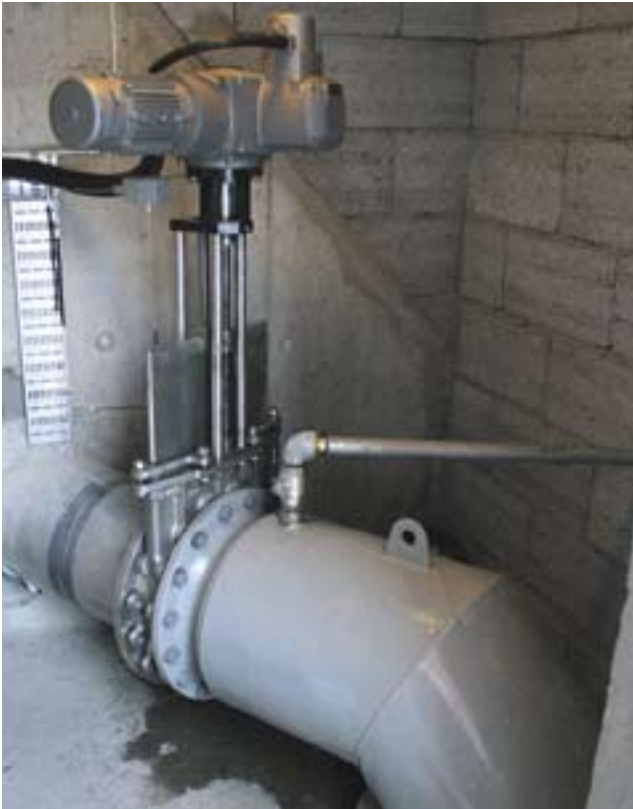
Minstevannføring og at eventuelle omløpsventiler fungerer som forutsatt er et eksempel på forhold som skal kartlegges og som det skal utarbeides rutiner for ettersyn og kontroll av. Moelv kraftverk
