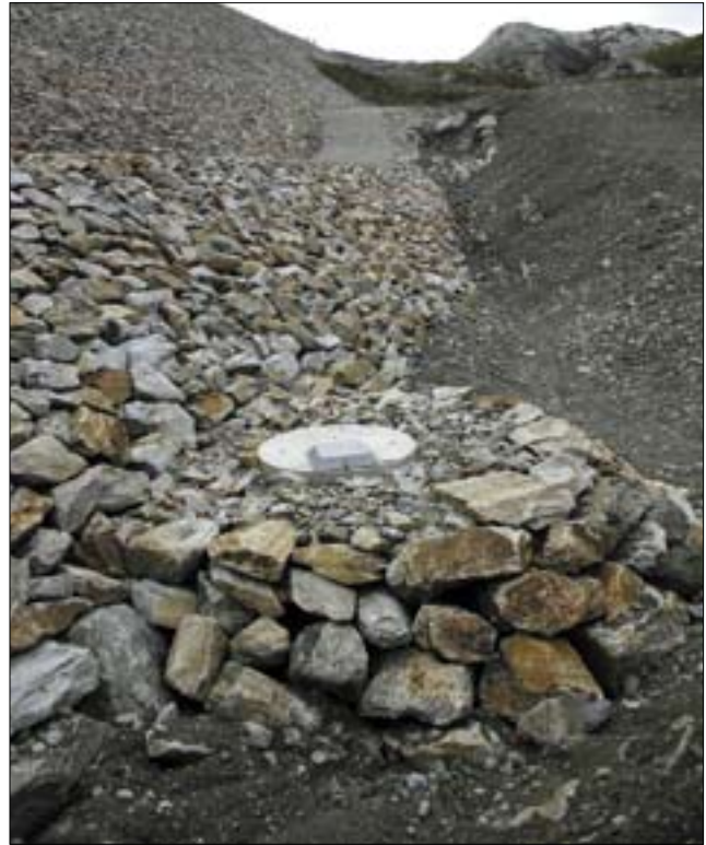
Hjelpeanlegg bør planlegges og utføres som en del av et helhetlig damanlegg. Her er utstyr for lekkasjemåling plassert i kum forblendet som en del av damkonstruksjonen. Dam Volavatn, Evanger
