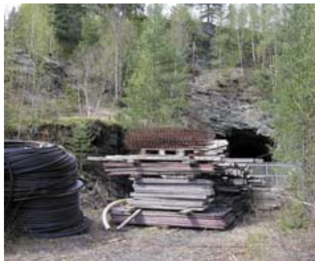
Finnto feil! 1: Tverrslaget er dårlig sikret. 2: Tverrslagsområdet er tatt i bruk som uplanlagt lagerplass/avfalls plass
