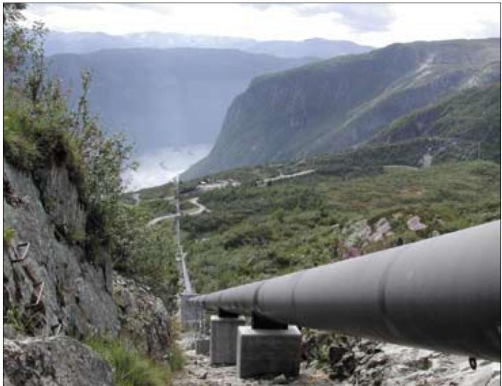
Rørgater kan være store konstruksjoner med betydelige landskapseffekter. Høyanger. Foto: Trine Hess Elgersma/Statkraft
