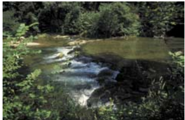
Bassengterskel med uregelmessig krone som bidrar til at terskelen ser ut som en mer naturlig del av vassdraget. Elva Mangfall, Bayern, Tyskland Foto: Knut Svendheim/NVE
