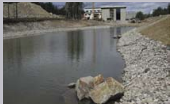
Utløpet fra kraftverket bør i størst mulig grad formes med skråninger, ikke loddrette fjellvegger. Skråninger reduserer behovet for sikringstiltak og gir utløpskanalen en bedre landskapsmessig tilpasning. Nedre bilde viser kanalen under bygging og vannstanden er ca 50-70 cm under driftsvannstand. Lutufallet (øverst) og Nye Sagnfossen (nederst) kraftverk.
