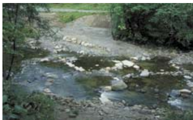
Celleterskelen skaper et spennende vannmiljø. Den sprer erosjonsbelastningen og kan bygges der grunnforholdene er for dårlige for vanlige bassengterskler. Sandvikselva.
