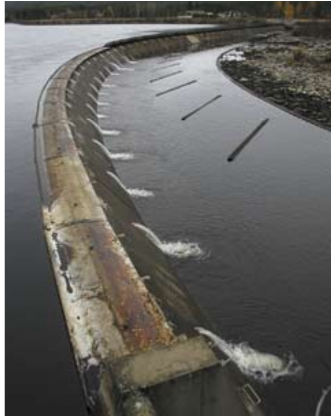
Slipp av minstevannføring bør registreres for å dokumentere at anlegget drives i samsvar med konsesjonsvilkårene. Strandfossen, Glomma.
