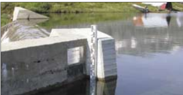
Målestav satt inn i u-profil av aluminium for å beskytte mot påkjenninger fra is
