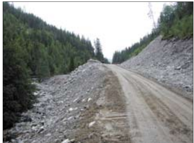
Selv beskjedne anleggsveier kan medføre betydelig inngrep. Her er veien gravd inn i en bratt moreneskråning og omfattende erosjon er utløst. I tillegg er utgravd masse fylt ut slik at elva i dalbunn har fått endret leie og i tillegg graver i fyllingsfoten. Kiva minikraftverk.
