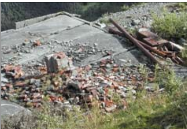
Betongfundament som er skjemmende eller medfører fare for folk eller vilt i området bør fjernes. Foto: Oddvar Olavsén/Statkraft
