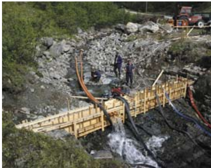
I enkelte vassdrag med pålegg om minstevannføring mangler stabile måleprofiler. Da er det aktuelt å bygge måleterskler som her i Kalvedalsbekken ved Kalvedalen kraftverk. Målepunkt for minstevannføring skal kartfestes
