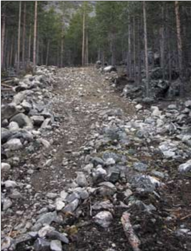
Midlertidig vei anlagt etter at det oppsto akutt behov for å komme til en luftesjakt vinterstid. Her kunne det med fordel vært brukt fiberduk og pukk på de slakeste delene av traseen. Omkringliggende vegetasjon er tilpasset langsom vekst i karrige og tørre omgivelser. Etablering av naturlig vegetasjon vil derfor ta lang tid.
