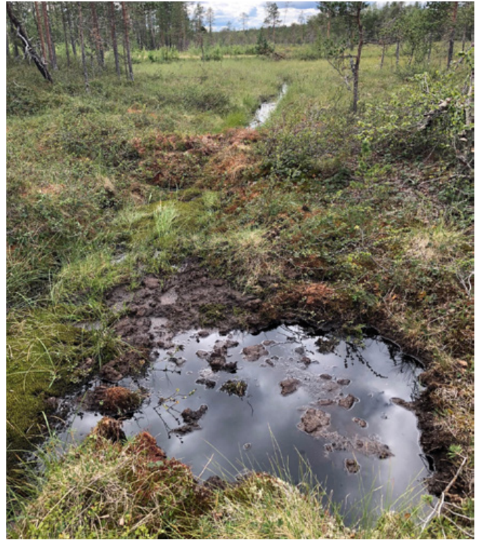
Grøfteplugg som er tettet med torv.
